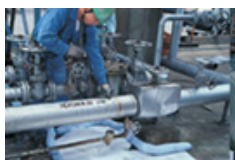
作業中の漏油に
