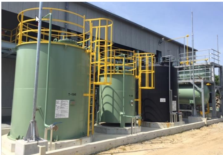
原料タンクヤード
