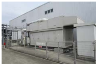
ガスコージェネレーションシステム (関東工場)
