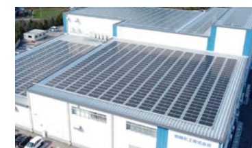
四国化工・西山第一工場 太陽光パネル
