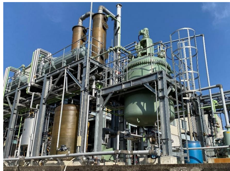
排ガス吸収塔(スクラバー)・受器
