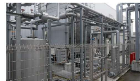
ガスコージェネレーションシステム(関東工場)
